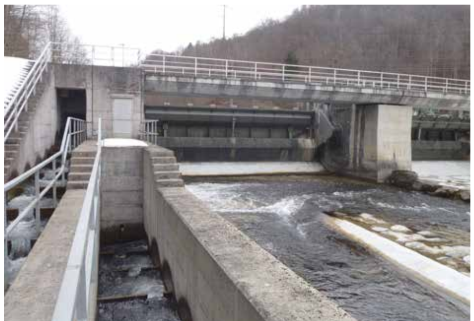
Abb. 1: Kraftwerkswehr mit nicht funktionierender Fischtreppe und zu wenig Restwasser (© SGS).
