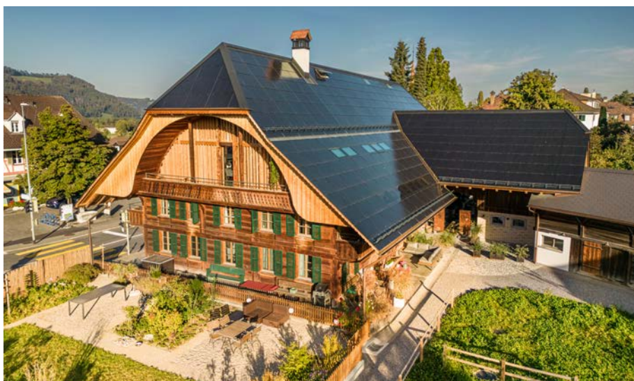
Abb. 1: Das denkmalgeschützte Bauernhaus von 1813 in Münsingen veranschaulicht wie historische Gebäude energetisch vorbildlich saniert werden können. Vor der Sanierung benötigt eine Wohnung 20 200 kWh pro Jahr; nach der Min. P-Sanierung noch 3400 kWh/a. Das 142% PEB-MFH erzeugt aber 78 400 kWh/a. Damit können sechs Wohnungen vollständig versorgt werden. Mit dem CO 2 -freien Solarstromüberschuss von 23 000 kWh/a können jährlich 15 E-Autos je 10 000 km CO 2 -frei fahren.
